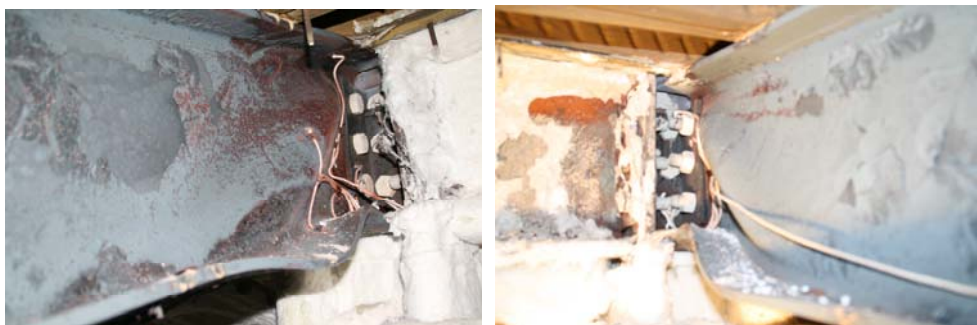
SI. 7.39 Lokalno izbočenje nezaščitene sekundarnega nosilca priključenega na steber
