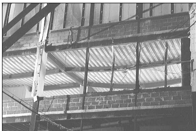
SI. 2.14 Deformirana konstrukcija med požarom
