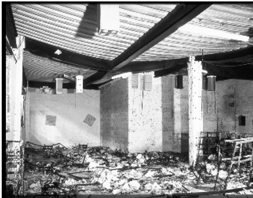
SI. 2.19 Notranjost projektnega območja po požaru
