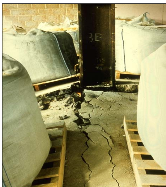
SI. 2.21 Razpokana betonska plošča v območja neprimernega stikovanja armature
