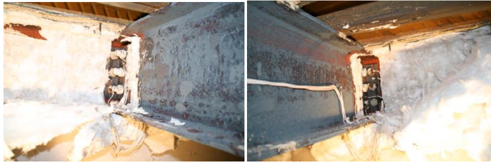
SI. 7.40 Na sekundarnih nezaščitenih nosilcih priključenih na primarne nosilce ni prišlo do lokalnega izbočenja
