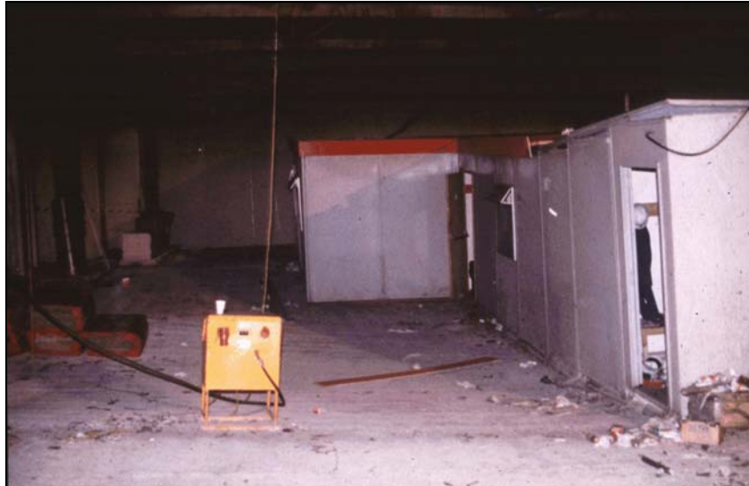
Sl. 4.2 Pogled na deformirana tla nad požarom (maksimalni pomik plošče je bil okrog 600 mm)
