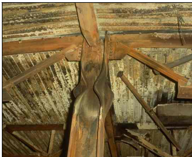
Sl. 4.1 Izbočenje na stebri in deformirane prečke v stavbi Broadgate
