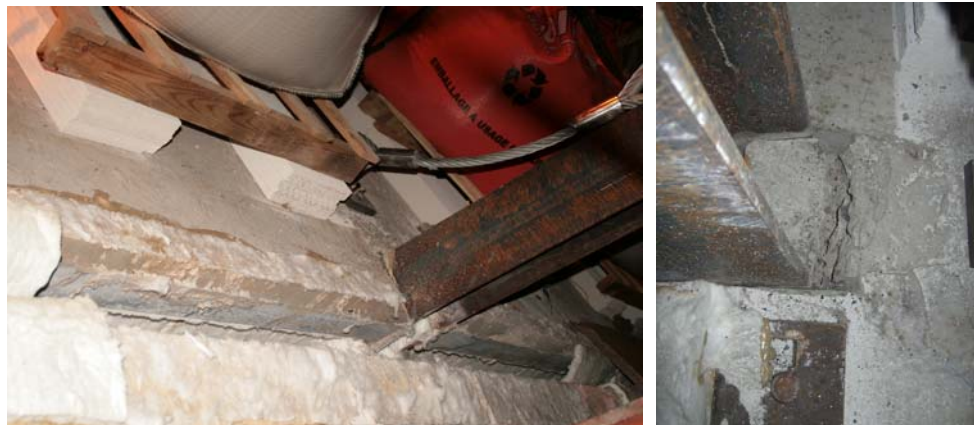
SI. 7.42 Razpokanje betona okoli srednjih stebrov
