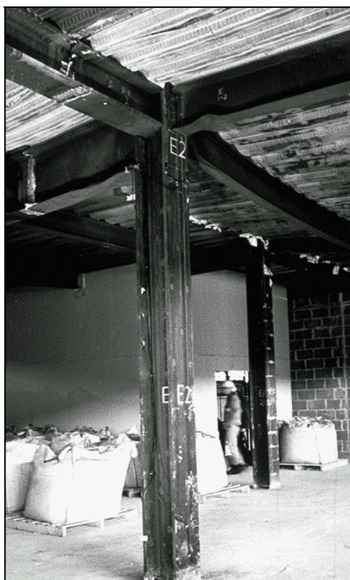
Sl. 2.10 Izgled konstrukcije po požaru
