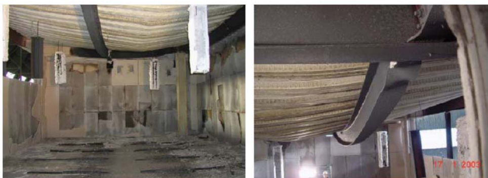
Sl. 2.25 Izgled deformirane plošče po požaru
