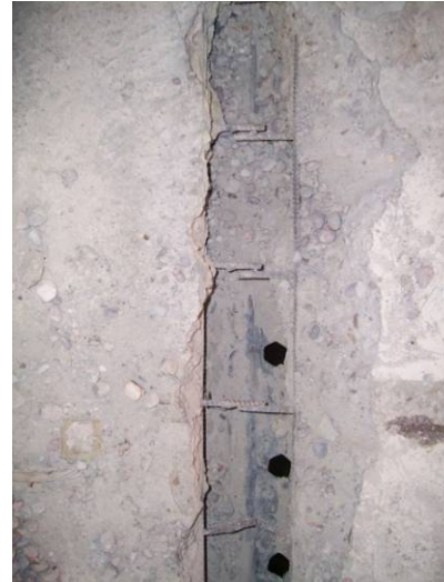
(b) Stanje stikov med armaturnima mrežama na mestu nastale razpoke po ohlajanju
