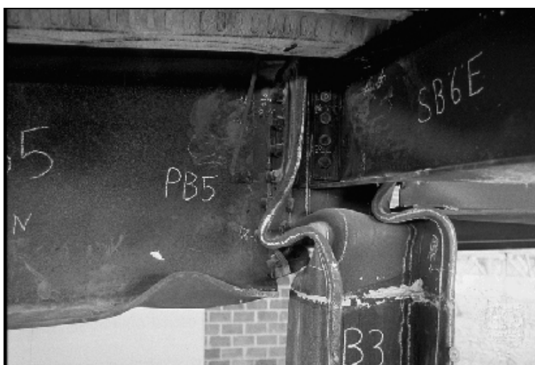
SI. 2.7 Po požarnem testu deformiran steber na vrhu
