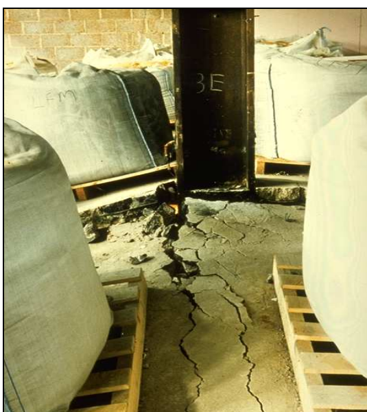
Rysunek 2.21 Pęknięta płyta stropowa w obszarze siatek pozbawionych zakładów
