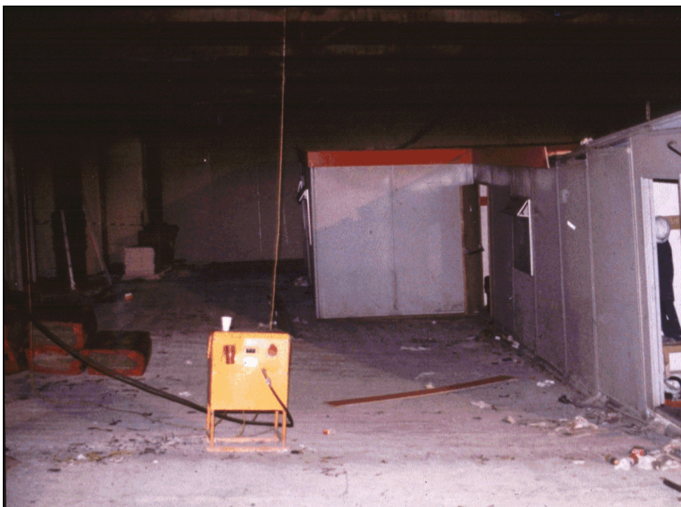
Rysunek 4.2 Widok zdeformowanego stropu ponad pożarem (maksymalne ugięcie wyniosło około 600 mm.)
