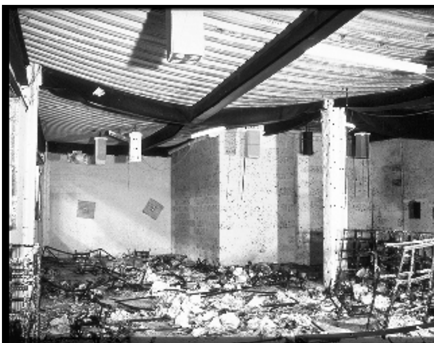
Rysunek 2.19 Widok pomieszczenia po pożarze
