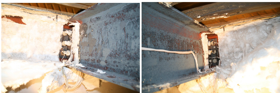
Rysunek 7.40 Brak lokalnej utraty stateczności niezabezpieczonych belek drugorzędnych zamocowanych do belek głównych
