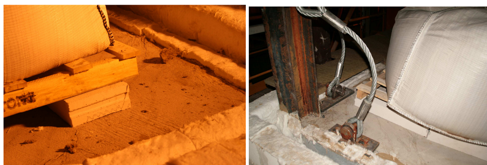
Rysunek 7.41 Pęknięcia betonu w narożnikach stropu
