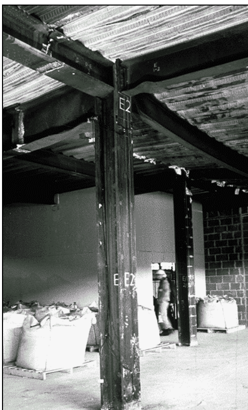
Rysunek 2.10 Widok konstrukcji po badaniu
