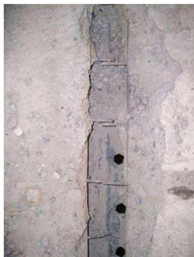
(b) Wygląd po studzeniu połączenia zbrojenia w miejscu pęknięcia
