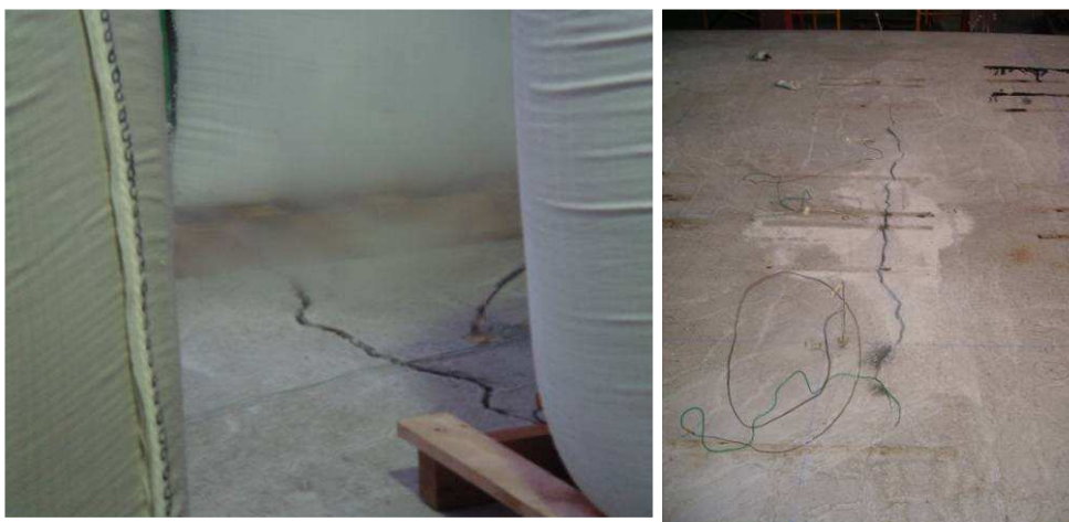
(a) Wygląd pęknięcia w części środkowej stropu
