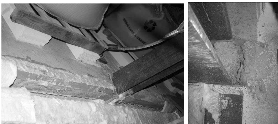
Obrázek 7.42 Trhliny v betonu u středového sloupu
