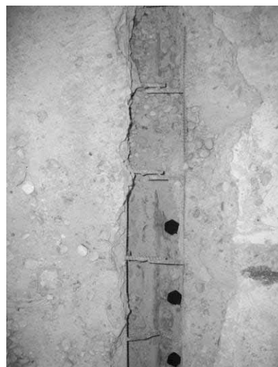
(b) Spoje výztuže v místě praskliny po ochlazení
