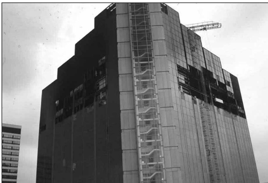
Obrázek 4.3 Objekt Churchill Plaza, Basingstoke po požáru
