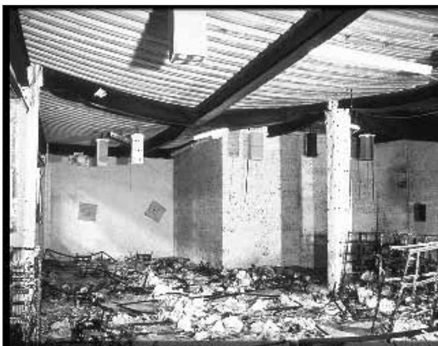
Obrázek 2.19 Požární úsek po zkoušce č. 6: Demonstrační zkouška
