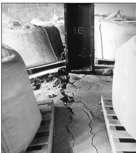
Obrázek 2.21 Popraskaná stropní deska v místech nepřekryté výztuže při zkoušce č. 6: Demonstrační zkouška
