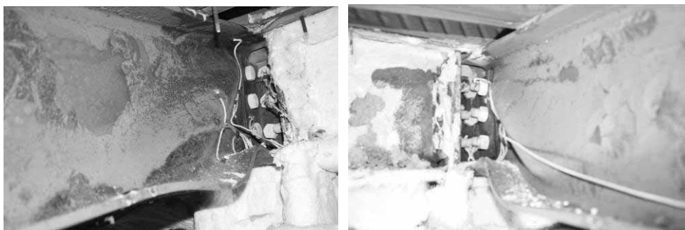
Obrázek 7.39 Lokální boulení nechráněné stropnice u sloupu
