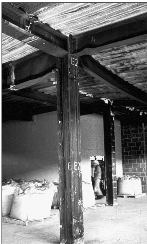
Obrázek 2.10 Pohled na konstrukci po zkoušce č. 3: Krajní požární úsek
