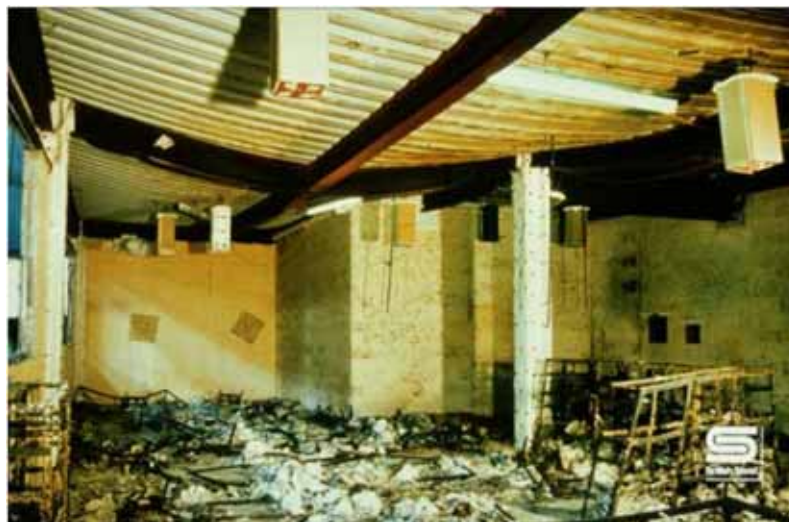
Průhyb stropnice 640 mm
