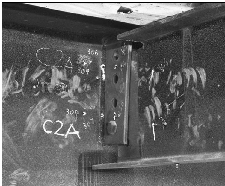
Obrázek 2.8 Přípoj čelní deskou na stojně nosníku po zkoušce č. 2: Rovinná soustava
