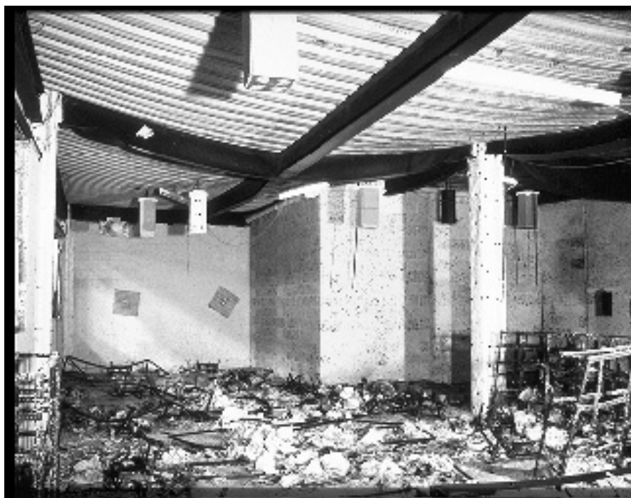
Obrázek 2.19 Požární úsek po zkoušce č. 6: Demonstrační zkouška
