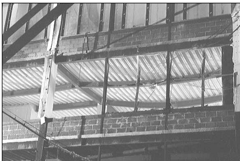
Obrázek 2.14 Deformovaná konstrukce během požáru u experimentu č. 5: Velký prostor
