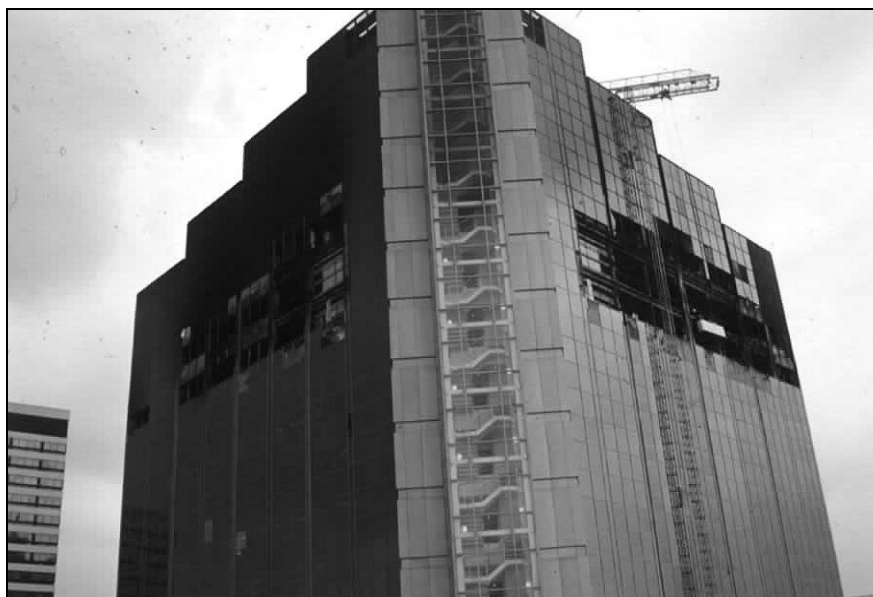
Obrázek 4.3 Objekt Churchill Plaza, Basingstoke po požáru
