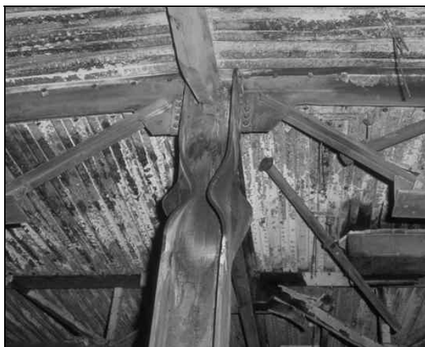
Obrázek 4.1 Sloup s lokálním boulením a deformace příhradového nosníku po požáru budovy v Broadgate
