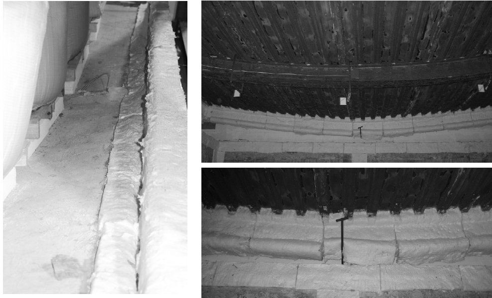
Obrázek 7.37 Porušený obvodový nosník
