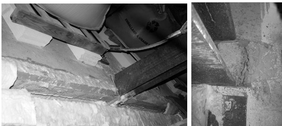
Obrázek 7.42 Trhliny v betonu u středového sloupu
