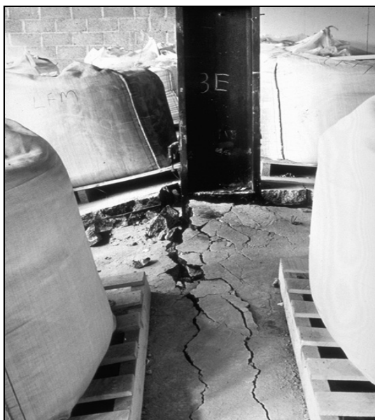
Obrázek 2.21 Popraskaná stropní deska v místech nepřekryté výztuže při zkoušce č. 6: Demonstrační zkouška
