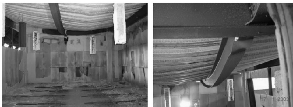
Obrázek 2.25 Pohled na strop po zkoušce při zkoušce č. 7: Vnitřní požární úsek
