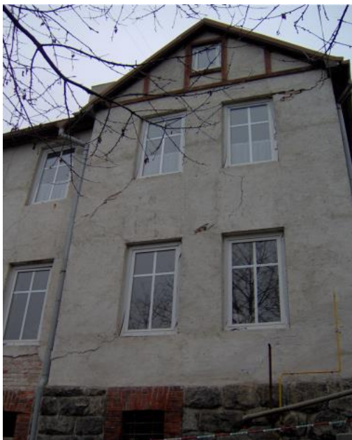
Obr. 23. Pohled na poškození vnější nosné zdi [2,3,5].
