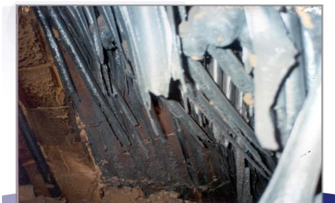
Obr. 9. Částečné roztavení trubek druhého tahu [2,3,5].
