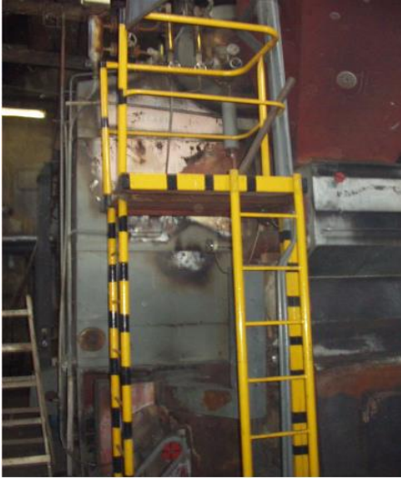
Obr. 12. Vnější poškození klecového kotle S 2500 U [2,3,5].
