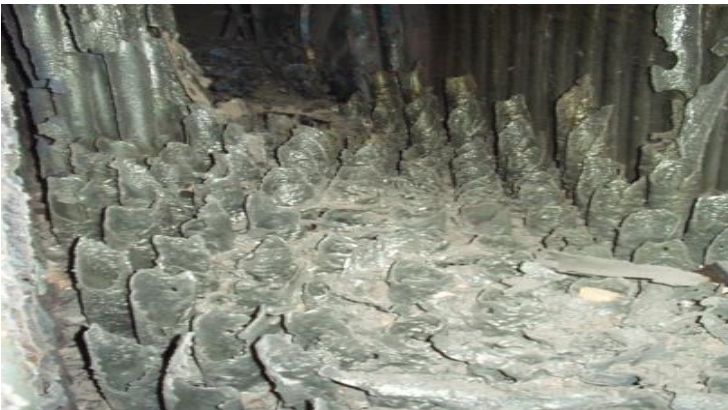
Obr. 14. Detail vnitřního poškození klecového kotle S 2500 U [2,3,5].
