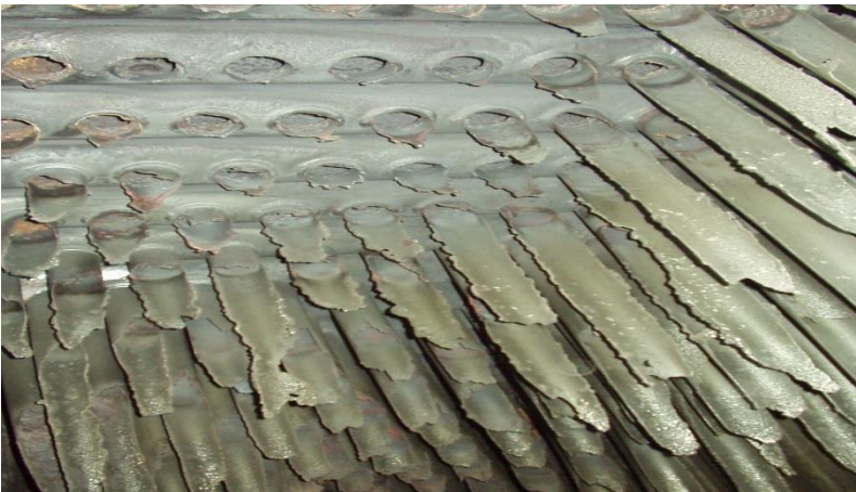
Obr. 13. Vnitřní poškození klecového kotle S 2500 U [2,3,5].
