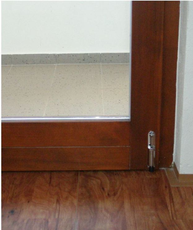
Obr. 17 – Závada – ocelový klín u požárních dveří, znemožňuje uzavření autor: Stanislav Bastl PuP, s.r.o.
