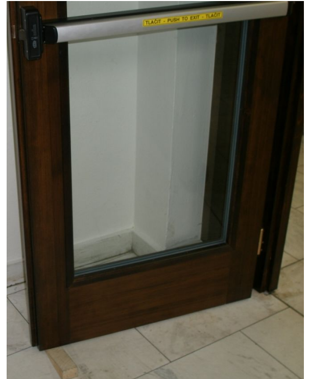
Obr. 18 – Závada – dřevěný klín u požárních dveří, znemožňuje uzavření autor: Stanislav Bastl PuP, s.r.o.
