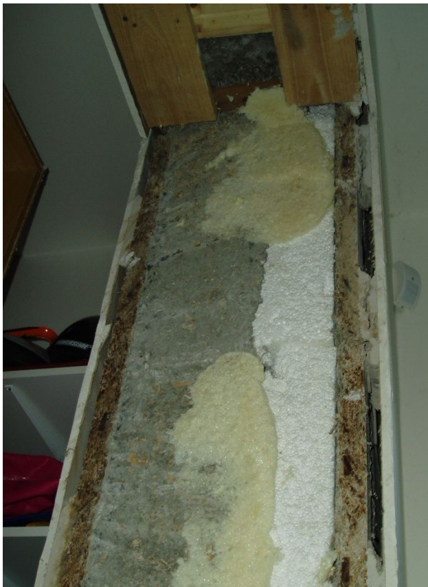
Obr. 19 – Závada – hořlavá pěna pod zárubní, výplň hořlavým materiálem (polystyren) autor: Stanislav Bastl PuP, s.r.o.
