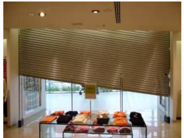
Obr. 20 – Závada – poničená ocelová roleta – po naražení na překážku [21]
