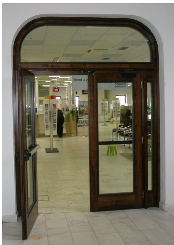
Obr. 7 – Požární dveře s panickým kováním, nadsvětlíkem, samozavírači a koordinátorem autor: Stanislav Bastl PuP, s.r.o.
