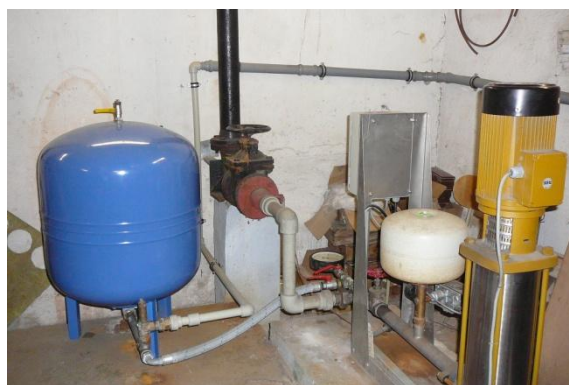
Obrázek 11 Čerpadlo pitné vody pro budovu B
