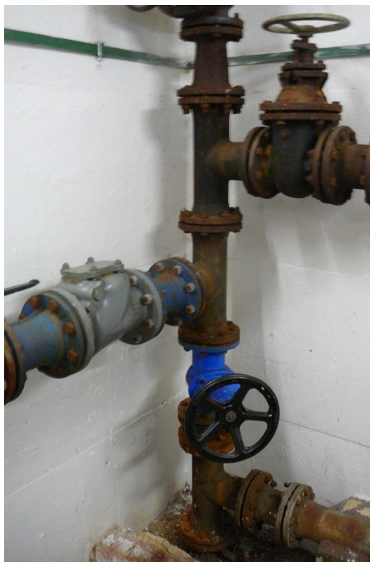
Obrázek 10 Vodoměrná sestava a odbočka pitné vody (nahoru) a požární vody (dolů)
