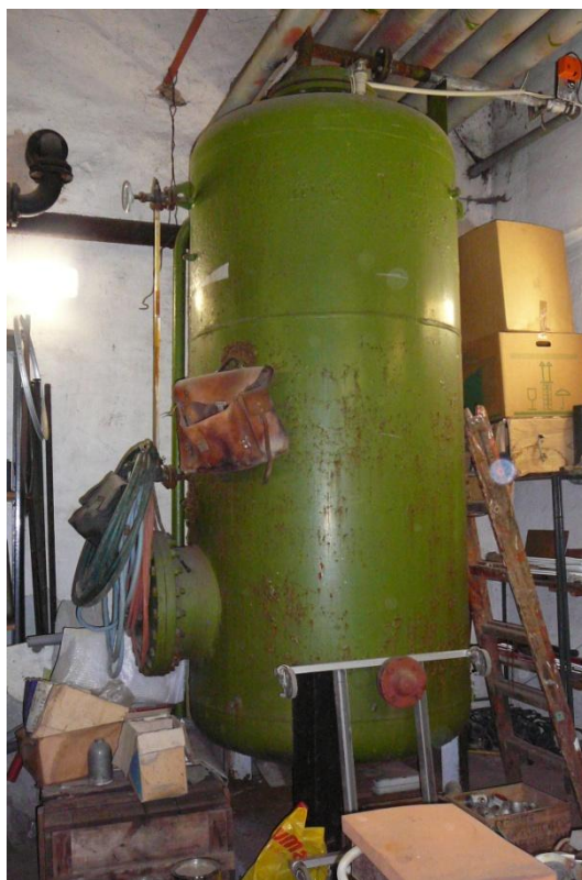
Obrázek 12 Čerpadlo pitné vody pro budovu A
