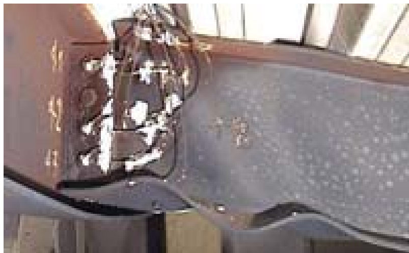
Obr. 4 Poškození přípoje ocelových konstrukce (Cardington 1993)
