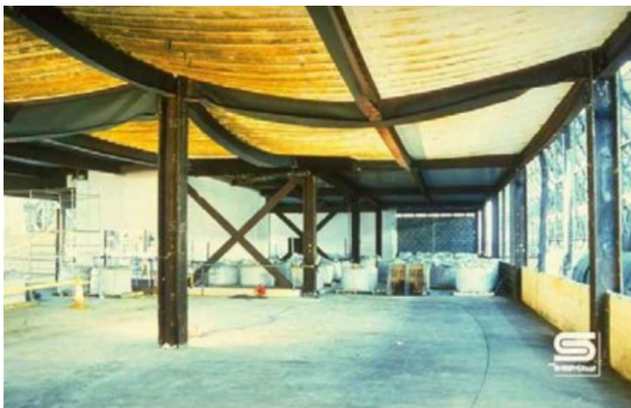
Obr. 1 deformace ocelobetonové desky po požáru (Cardington, 1993)
