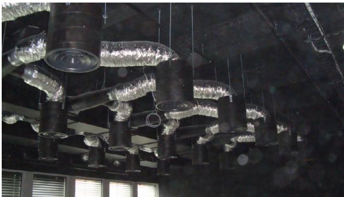
Obrázek 10: Rozvody VZT ve zrekonstruovaných posluchárnách budovy C - jižní část (foto V. Koubová, 2012)
