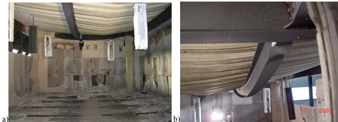
Obr. 2a) Požární úsek po požáru, b) zbytková deformace ocelobetonové desky 925 mm
