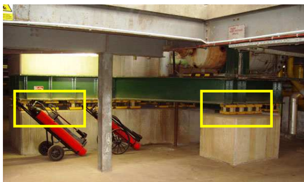
Obr. 11 Pružně uložený základový rám pístového kompresoru INGERSOLL RAND C v podniku CHEMOPETROL a.s. v Litvínově-Záluží (převzato z [23]).
