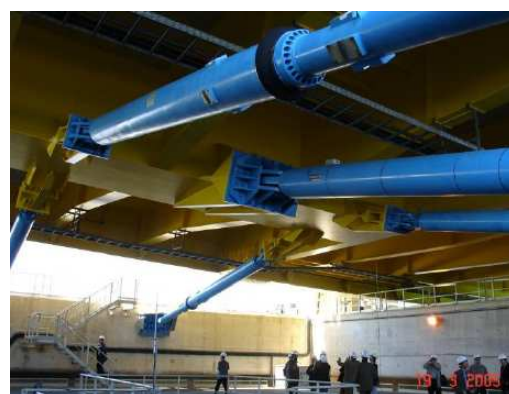
Obr. 30 Vpravo tlumiče mostovky mostu Rion-Antirion na poloostrově Peloponés v Řecku (převzato z [33]).
