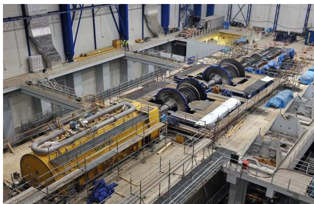
Obr. 7 Turbostolice v elektrárně Ledvice (zdroj: Skupina ČEZ).
