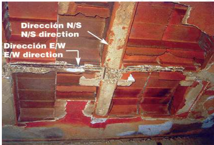
Odpadnutí podhledu a keram. vložek
