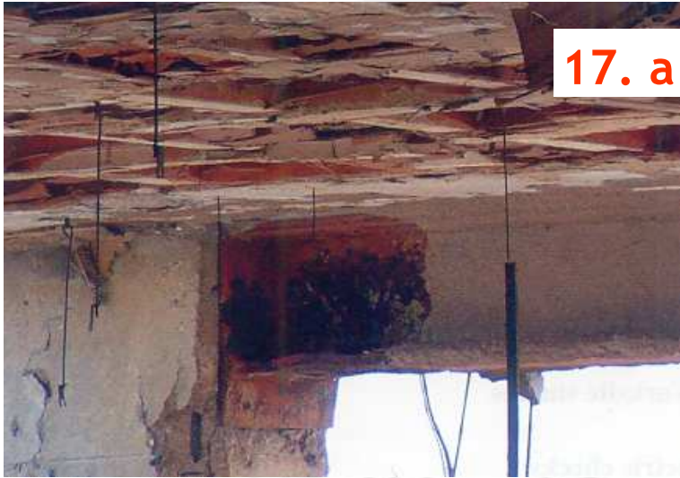
Porušení ohnivzdor. ochr. spřaž. nosníku
