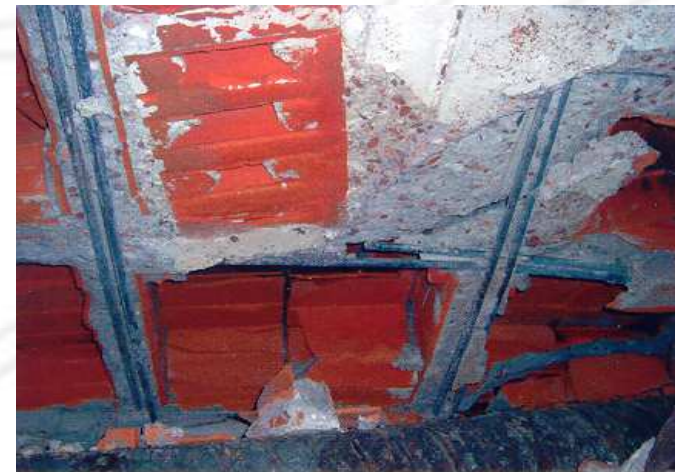
Odpadnutí krycí vrstvy výztuže
