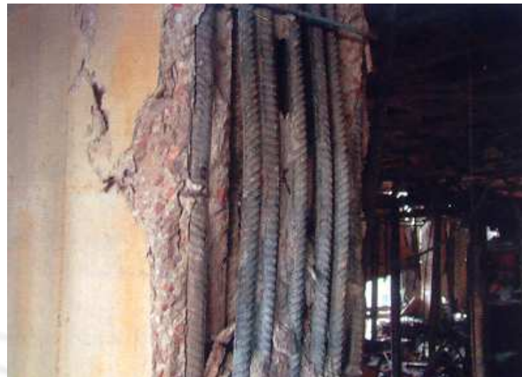
Vybočené pruty v 8. podlaží
