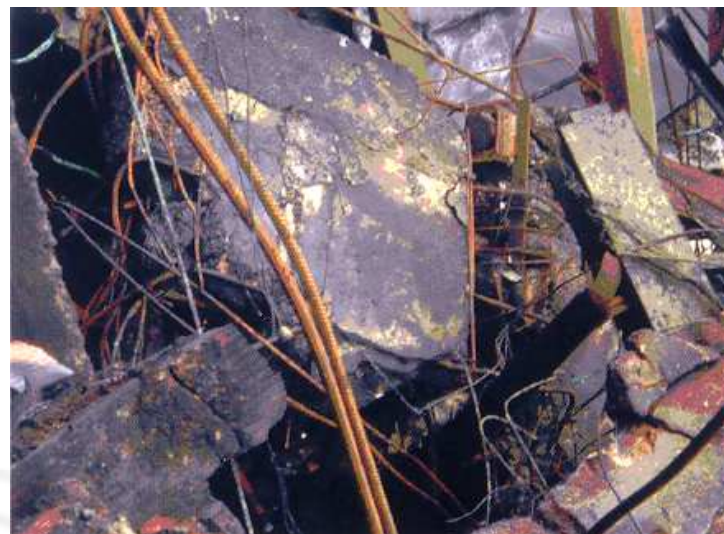
Zbytky zříceného ŽB stropu
