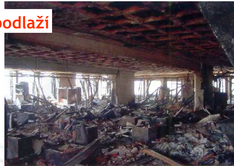
Odpadnutí podhledu a vložek
