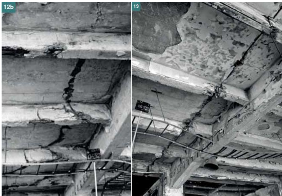
Obrázek 5: poškození v místě pracovních spár a poškození v místě dilatací [3]
