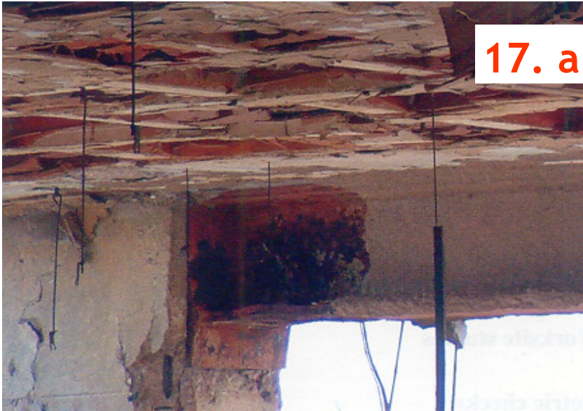
Porušení ohnivzdor. ochr. spřaž. nosníku
