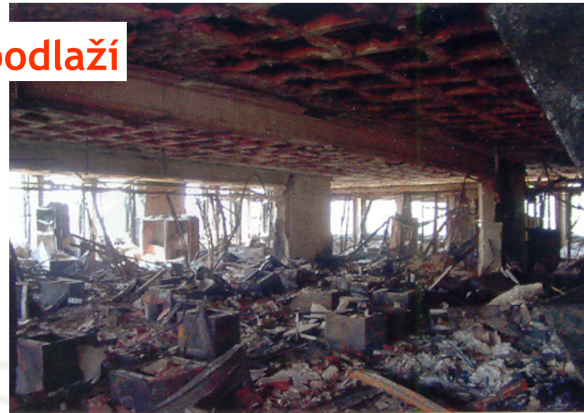
Odpadnutí podhledu a vložek
