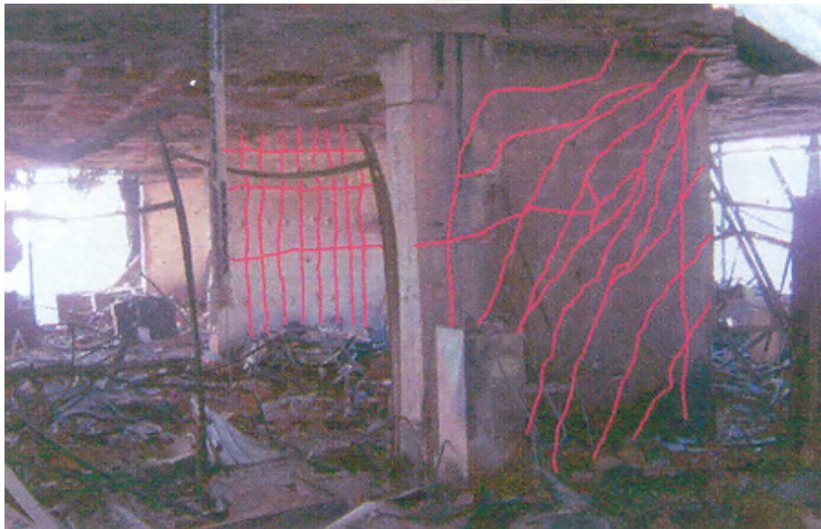
Trhliny ve sloupech v 16. podlaží
