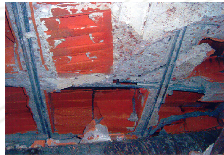
Odpadnutí krycí vrstvy výztuže
