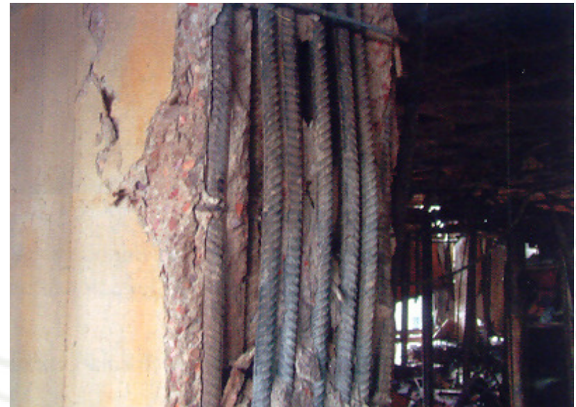
Vybočené pruty v 8. podlaží
