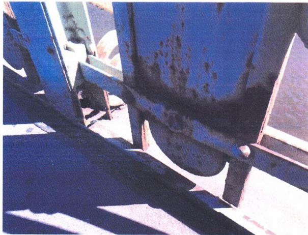
Obr. 2 Současný stav protikorozní ochrany zábradlí Čechova mostu
