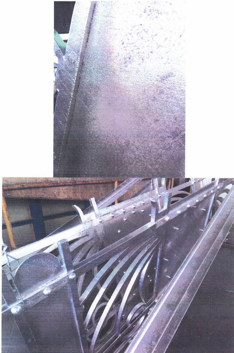
Obr. 6 Žárově zinkované zábradlí bez vad po spálené nátěrové hmotě
