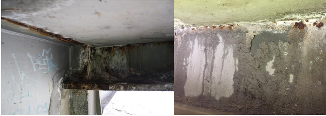
Obr. 25 Přítomnost chloridů z vozovky a následné podkorodování a delaminace OPS ocelových prvků
