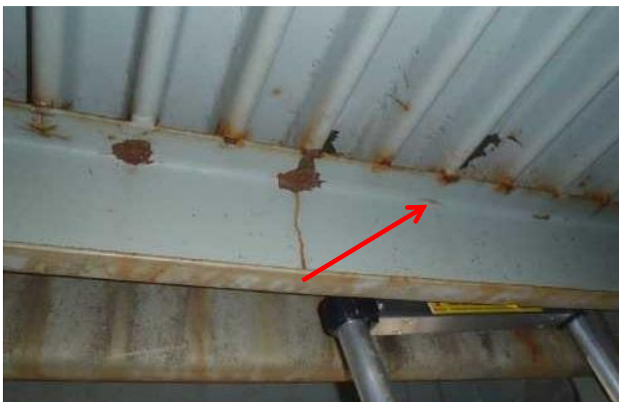
Obr. 6 Zjištění únavové trhliny vznikem koroze v jinak celistvém nátěru, vlevo po odstranění nátěru
