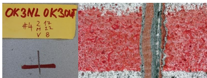
Obr. 21 Ukázka destruktivního měření tloušťky a stanovení skladby OPS - základní nátěr 170 \mu\text{m} , mezivrstva 220 \mu\text{m} a vrchní nátěr 80 \mu\text{m} (vlevo); mikrosnímek měřeného řezu (vpravo)
