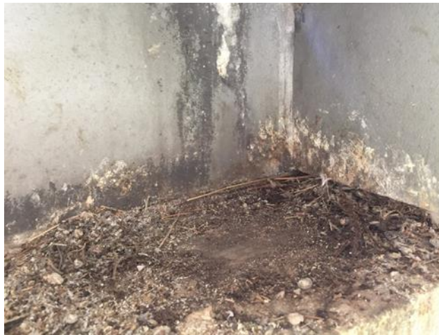
Obr. 26 Ptačí trus a degradace OPS ocelových prvků
