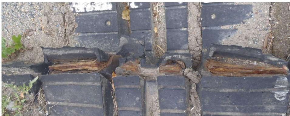
Obrázek 33: Kobercový mostní závěr - poškození prvků, rozpad v oblasti svarů a vnitřních výztuh
