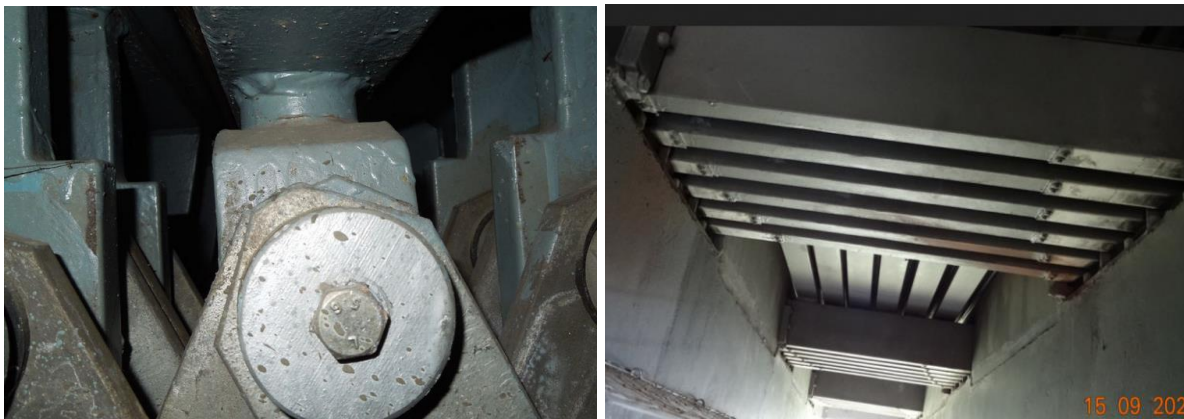
Obrázek 29: Vlevo trhlina v napojení středové lamely, vpravo korozní produkty – D0-192..2 před havárií MZ
