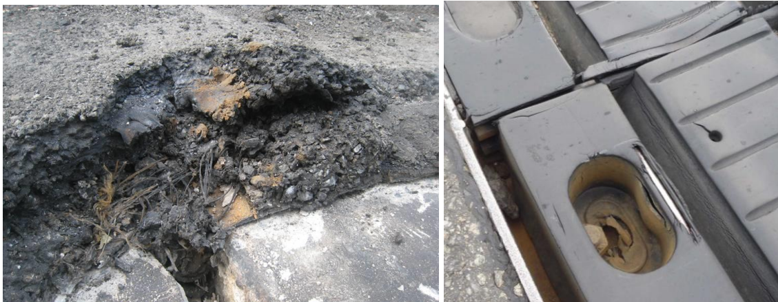
Obrázek 32: Elastický mostní závěr - nekvalitní provedení, vpravo kobercový závěr - chybějící kotvení
