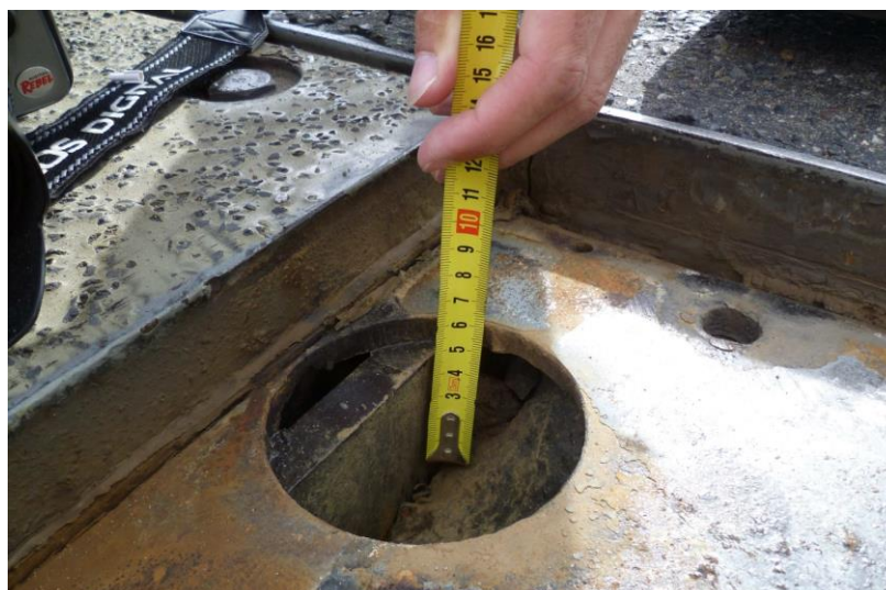
Obrázek 31: Hřebenový mostní závěr - praskání kotevních šroubů, kaverny v ukotvení a neprobetonované oblasti
