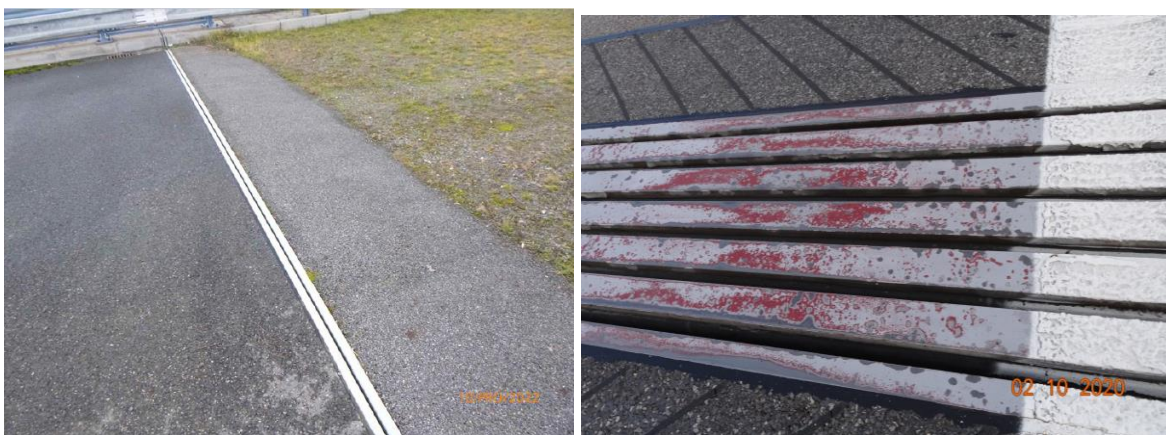
Obrázek 27: Sevřený mostní závěr nad opěrou, porucha založení, vpravo porucha PKO
