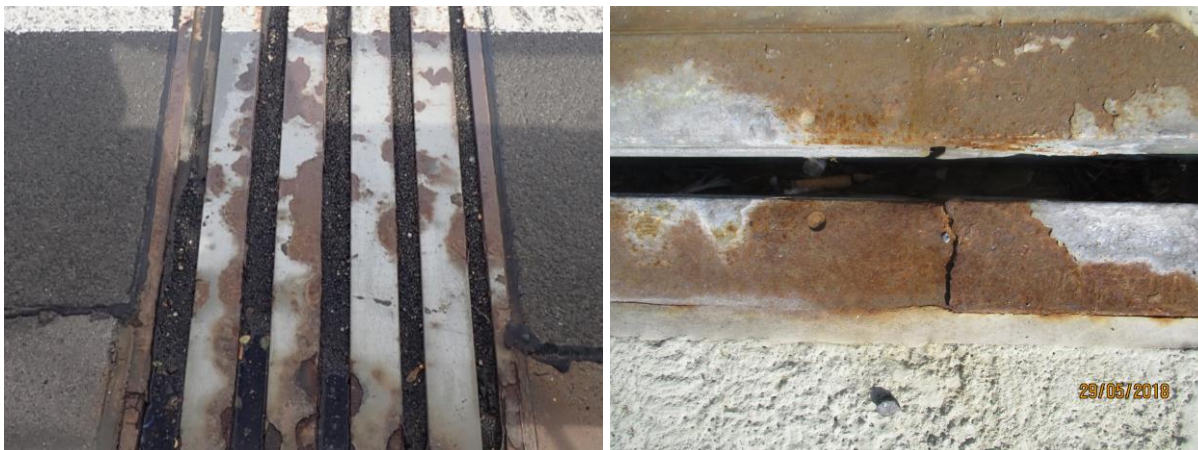
Obrázek 26: Vlevo poškození PKO svislých ploch (odlupování), místy začínající drobná povrchová koroze, vpravo rozsáhlá koroze MZ, prolomení profilů, nerovnoměrné rozevření lamel, deformace profilů apod.
