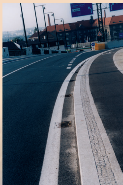
odvodnění mostu přes nádraží v Plzni
