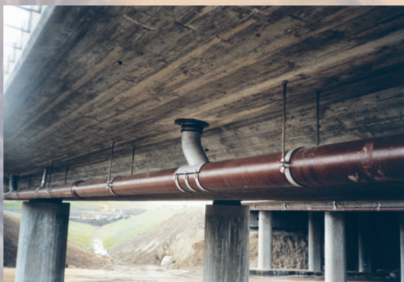
napojení odvodňovače na podélný svod
