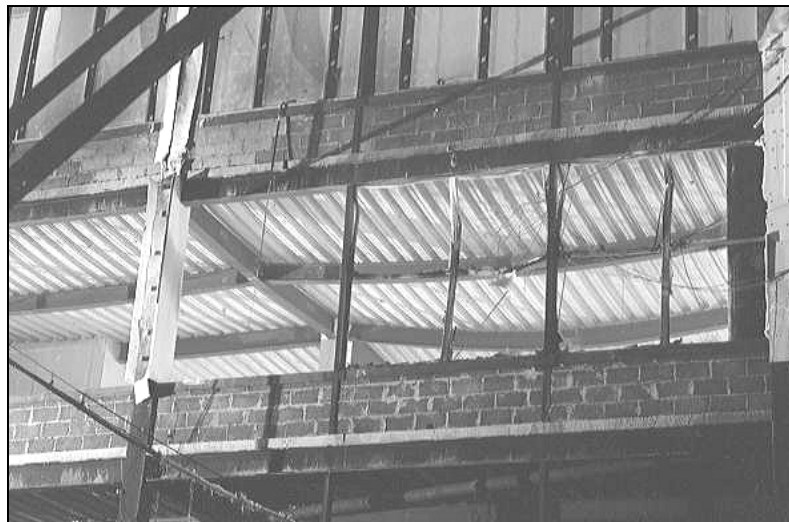
Figura 2.14 Estructura deformada durante el fuego
