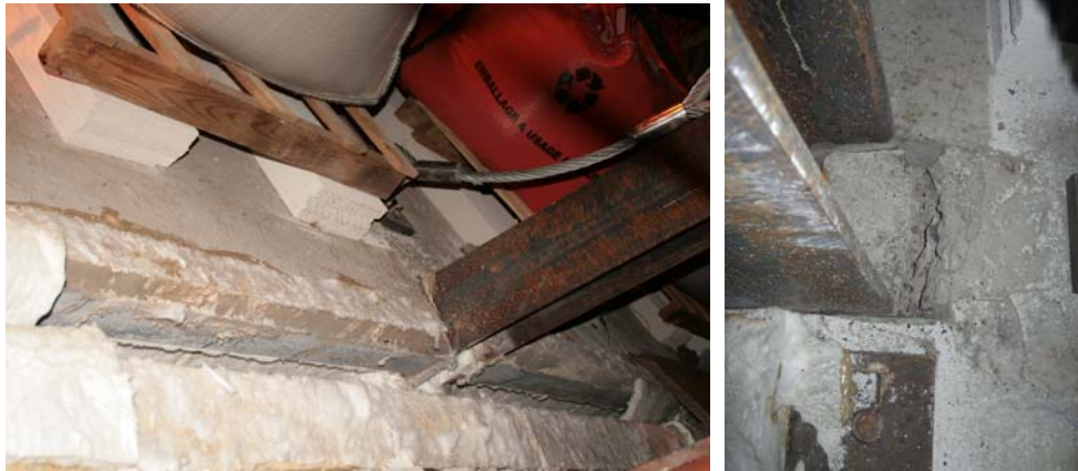
Figura 7.42 Agrietamiento del hormigón en torno a los pilares centrales
