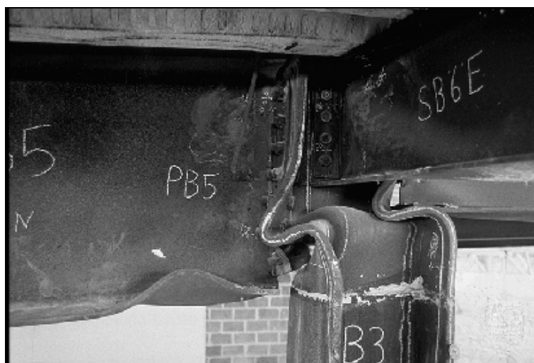
Figura 2.7 Capitel aplastado tras el ensayo
