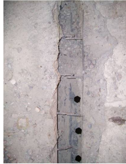
(b) Estado de la junta de armadura en el lugar de la grieta tras el enfriamiento
