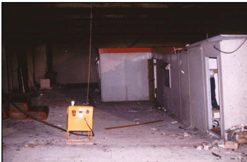
Figura 4.2 Vista del forjado deformado por encima del fuego (la flecha máxima era de unos 600 mm)
