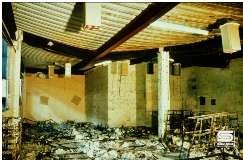
Estado deformado de la parte caliente del forjado colaborante
