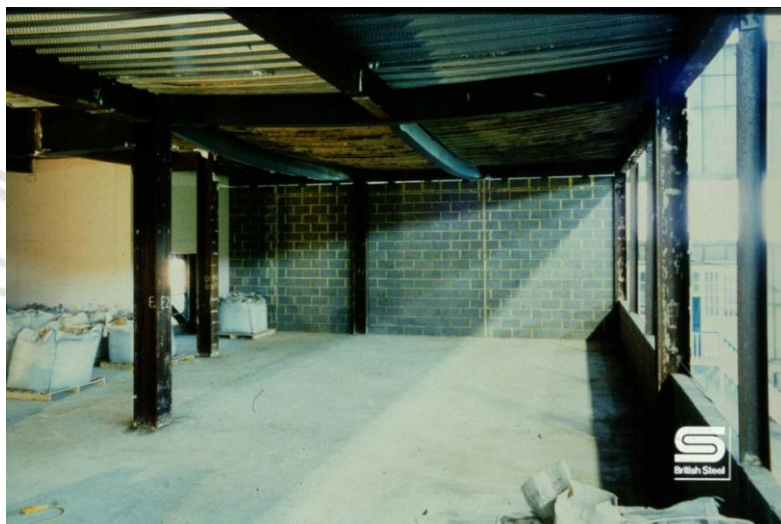
Stan deformacji nagrzewanej części stropu zespolonego
