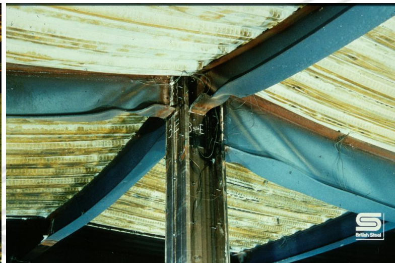
Stan deformacji elementów stalowych wokół zabezpieczonego słupa stalowego
