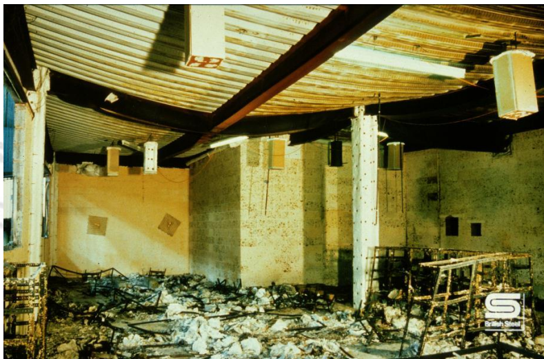
Stan deformacji nagrzewanej części stropu zespolonego
