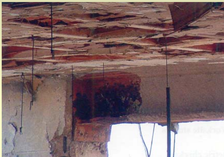
Porušení pož. ochr. spřaž. nosníku
