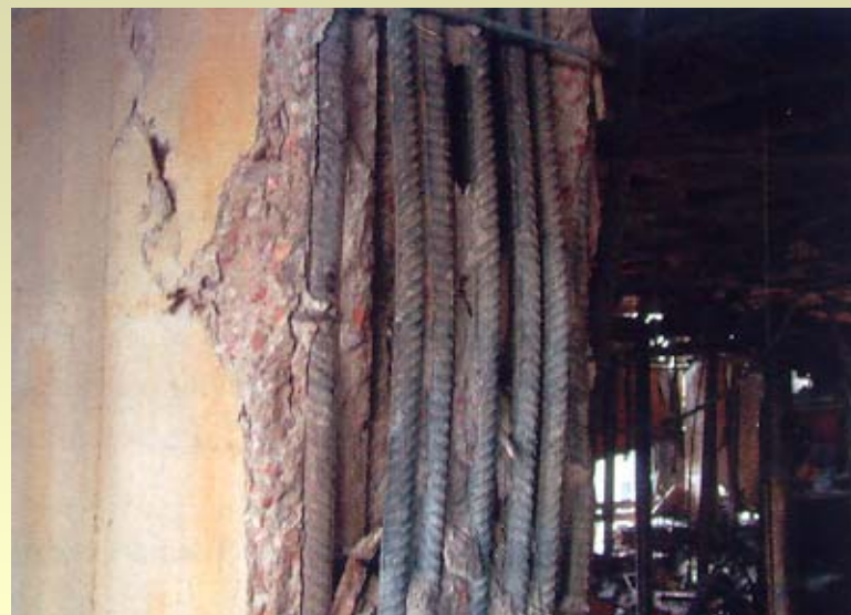
Vybočené pruty v 8. podlaží
