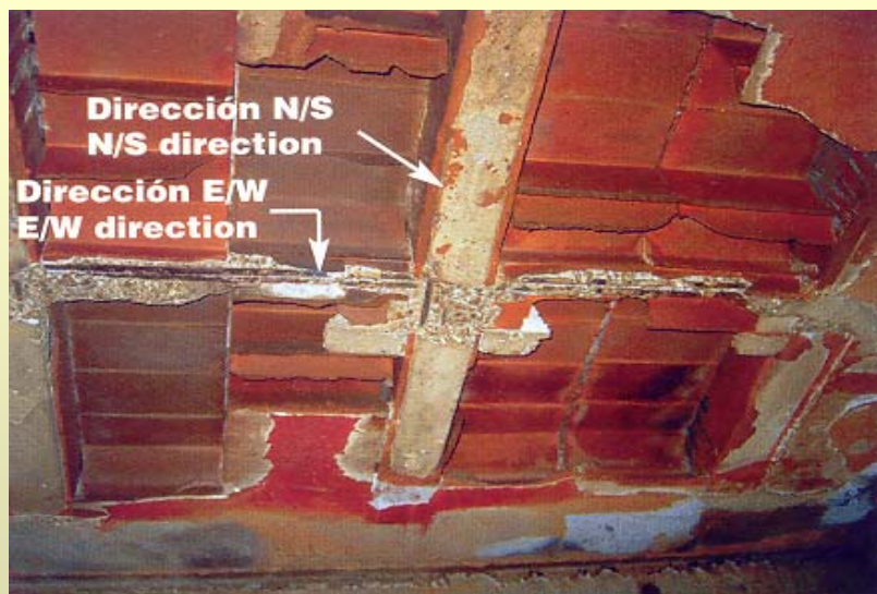
Odpadnutí podhledu a keram. vložek
