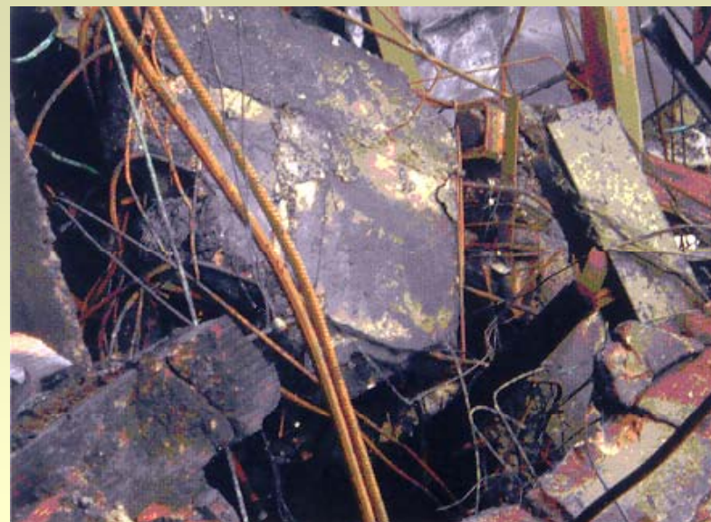
Zbytky zříceného želbet. sloupu
