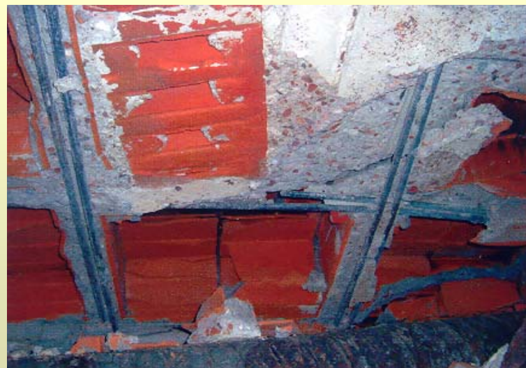
Odpadnutí krycí vrstvy výztuže 12
