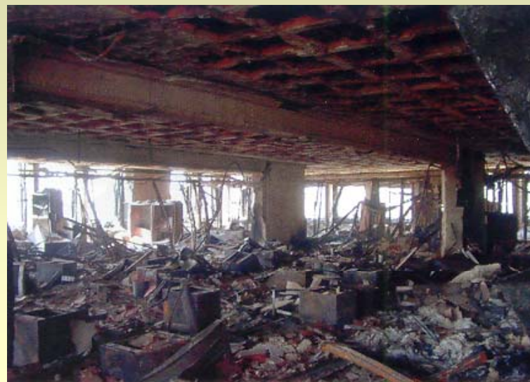
Odpadnutí podhledu a keram. vložek
