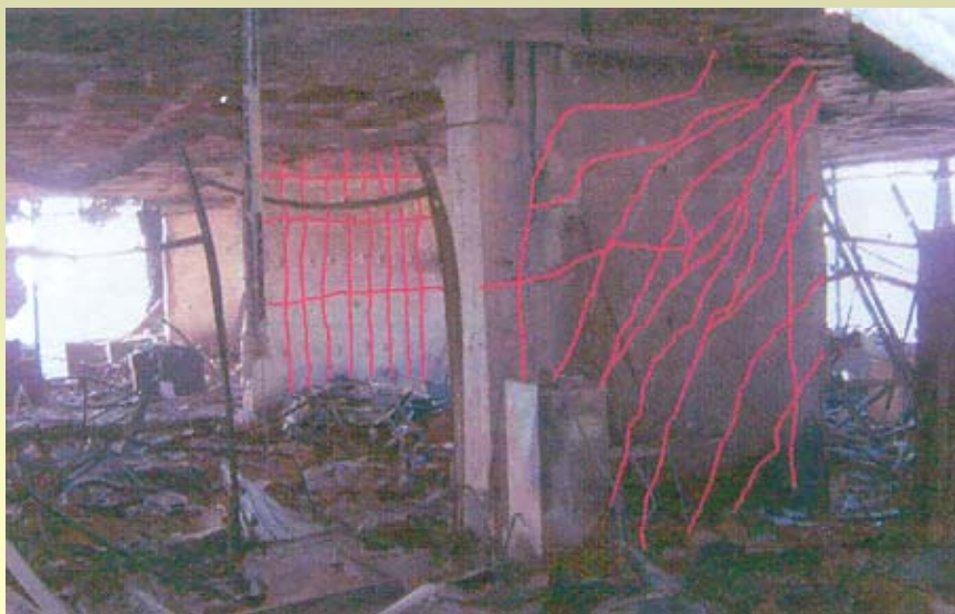
Trhliny ve sloupech v 16. podlaží
