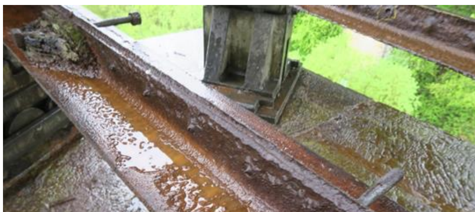
Obr. 42 Korozní oslabení prvku ztužení pod příčником nad podpěrou - nýty do špičky
