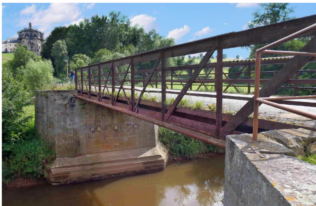
Obr. 51 Most před rekonstrukcí
