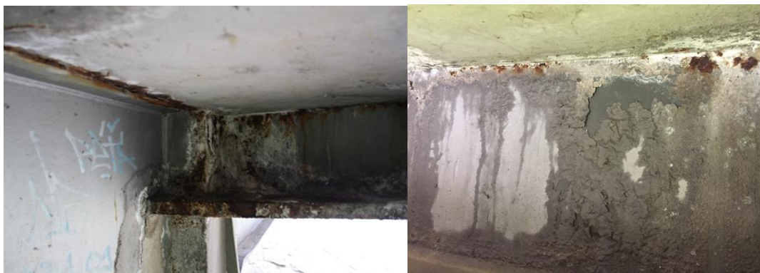
Obr. 26 Přítomnost chloridů z vozovky a následné podkorodování a delaminace OPS ocelových prvků
