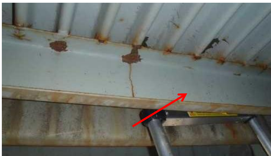
Obr. 3 Zjištění únavové trhliny vznikem koroze v jinak celistvém nátěru, vlevo po odstranění nátěru
