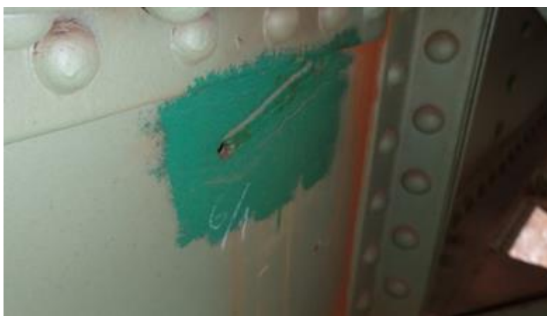
Obr. 35 Opravená únavová trhlina na stojině podélníku
