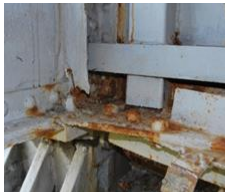
Obr. 40 Korozně oslabená podporová oblast (silniční most v Bohumíně)
