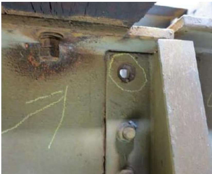
Obr. 6 Porušení přemáhaného šroubového spoje, podélník na železničním mostě
