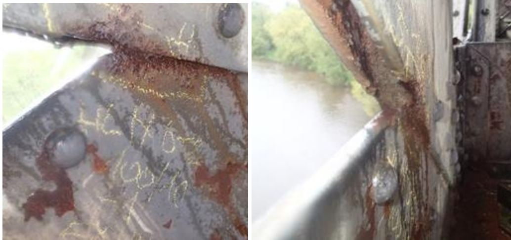
Obr. 43 Štěrbinová koroze mezi plechy tažené diagonály a stojinou dolního pasu - obecný stav
