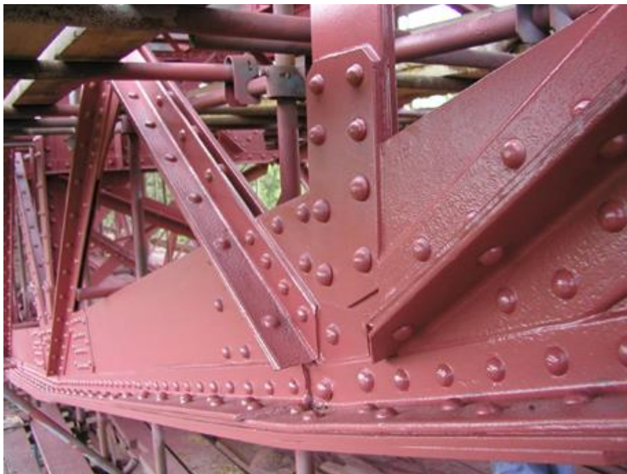
Obr. 36 Příklad opraveného nýtovaného styčnicku
