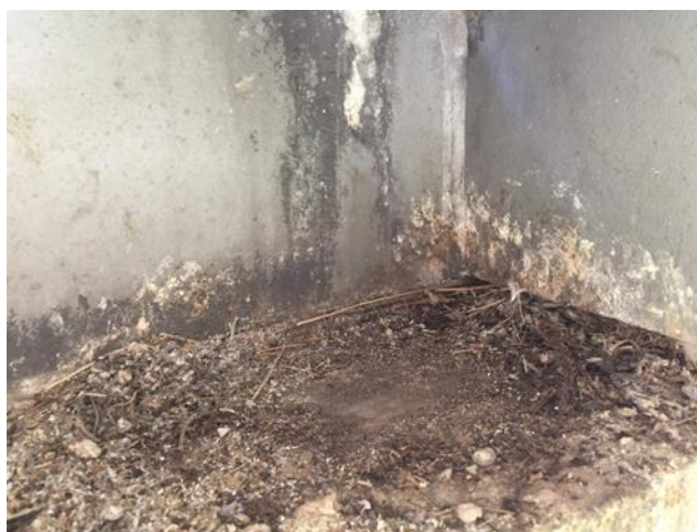
Obr. 27 Ptačí trus a degradace OPS ocelových prvků
