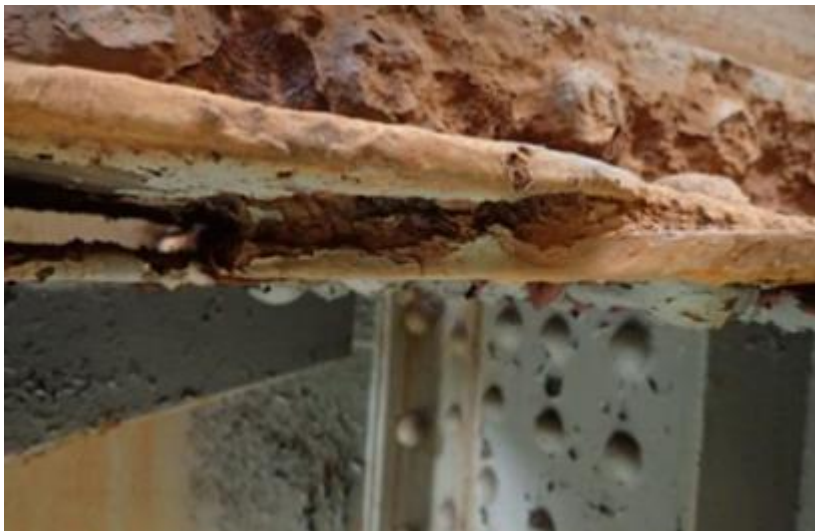
Obr. 5 Štěrbinová koroze poškozující nýtovaný spoj na železničním mostě, koroze hlaviček nýtu
