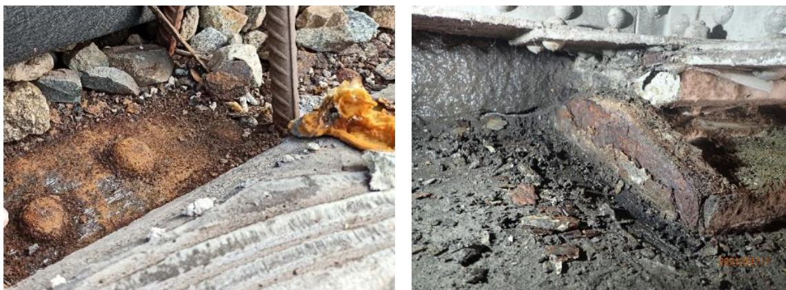
Obr. 49 Stav horní plochy na žlabinách, degradace a koroze ložisek
