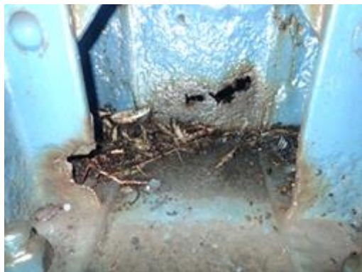
Obr. 39 Korozně oslabená podporová svisllice (silniční most v Praze-Vršovicích)
