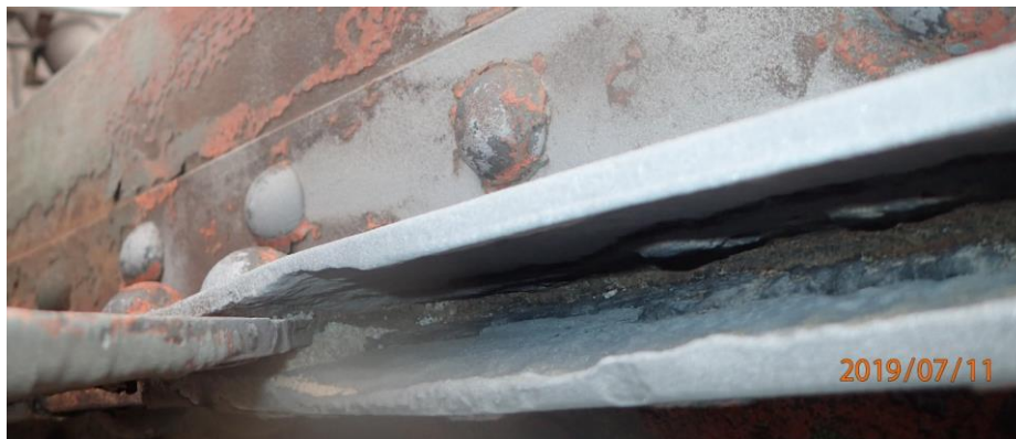
Obr. 16 Štěrbinová koroze, stav po otryskání, patrné korozní úbytky
