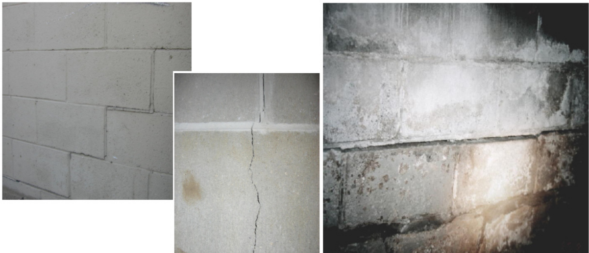
Obr. 20 Různé způsoby ohybového porušení suterénní stěny. Zleva doprava porušení schodovité, porušení kolmo na ložné spáry a nejnebezpečnější porušení v ložné spáře (zdroj: [13]).
