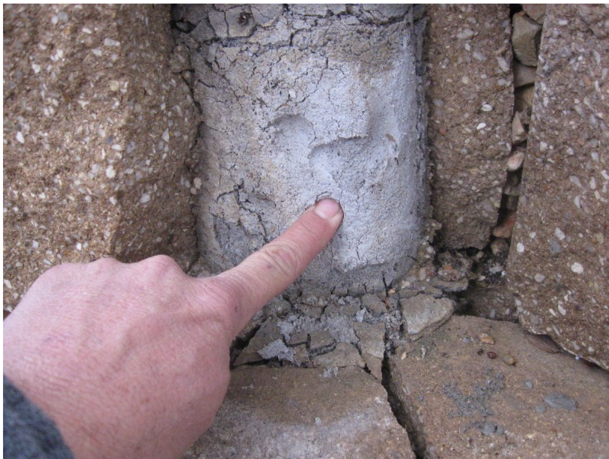
Neošetřený prvek vybetonovaný v chladném prostředí, znehodnocený beton, [5]
