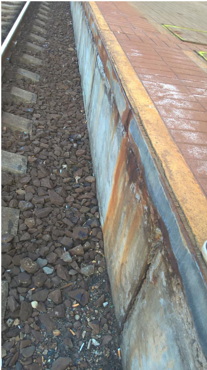
Obr. 1 – Porušená hrana nástupiště
